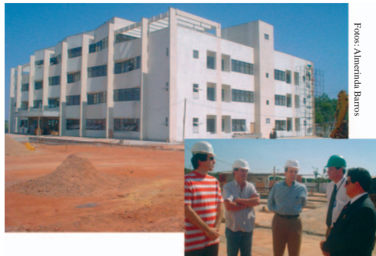
Diretor-Geral do TRF-1ª Região, Washington Ribeiro da Silva, Diretor da Divisão de Engenharia, Antônio Jorge Leitão, Engenheiros da Construtora e o Diretor da Secad, Divino Célio Carneiro.
