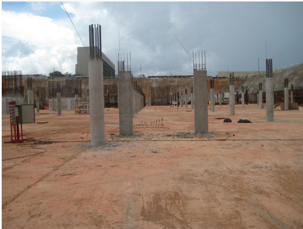
Foto 11 – Concreto Pilares 3º subsolo, trecho V entre os eixos 11 e 13, ref. Item 03.02.700 no Memorial descritivo
