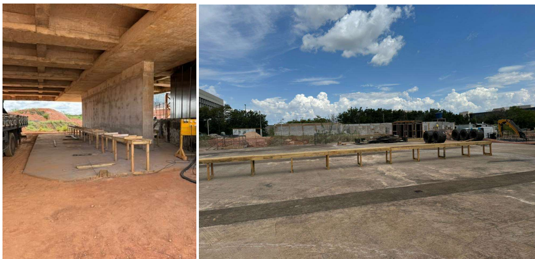
Foto 8 – Central de armadura.
